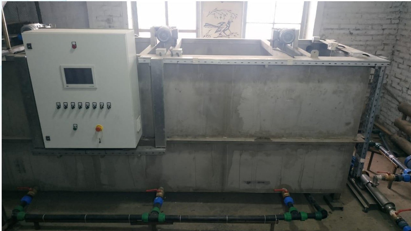
Установка очистки сточных вод и обезвоживания илового осадка на станции Аэрации
